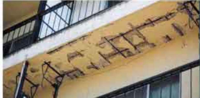
バルコニー床の剥離したコンクリートから鉄筋がのぞく
