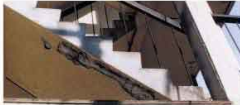
老朽化が進み、コンクリートが剥離した階段
